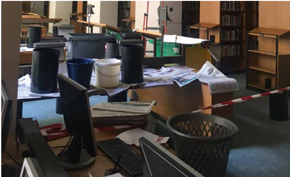
Wasserschaden in der Bibliothek: Mülleimer fangen im Lesesaal das ablaufende Regenwasser auf.
